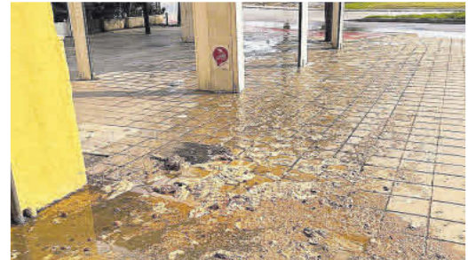
Vertido de heces y toallitas en una calle de Port Saplaya.
