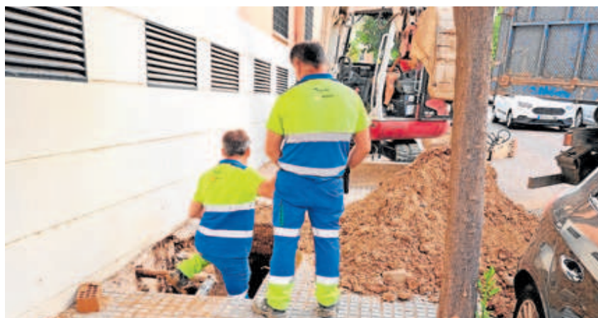
Empleados de Aqualia en el área donde se ha producido la avería en la avenida Vía de la Plata. HOY
